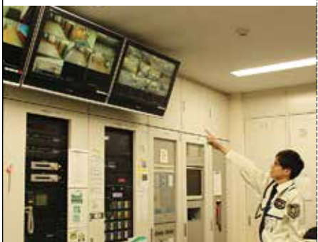
災害時に対応できるように総合監視盤を実際に作動させて訓練します
